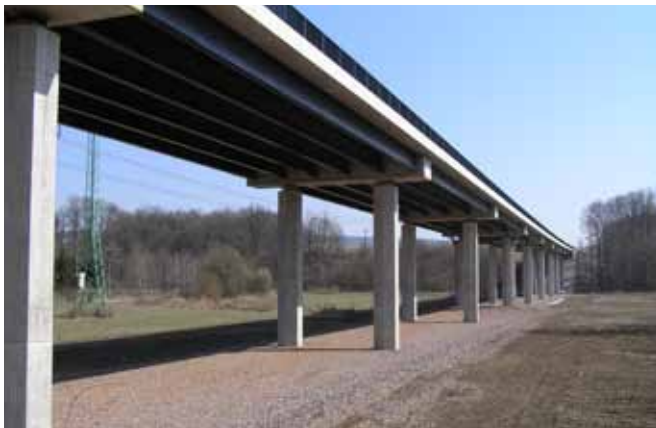
Dopravní stavby vystavené posypovým solím (mosty, tunely, protihlukové stěny apod.)
