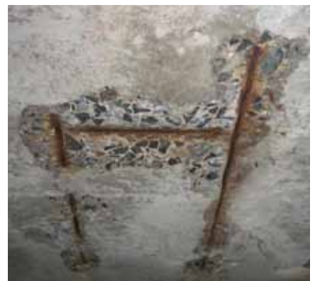
Veškeré konstrukce s nedostatečnou tloušťkou krycí vrstvy betonu
