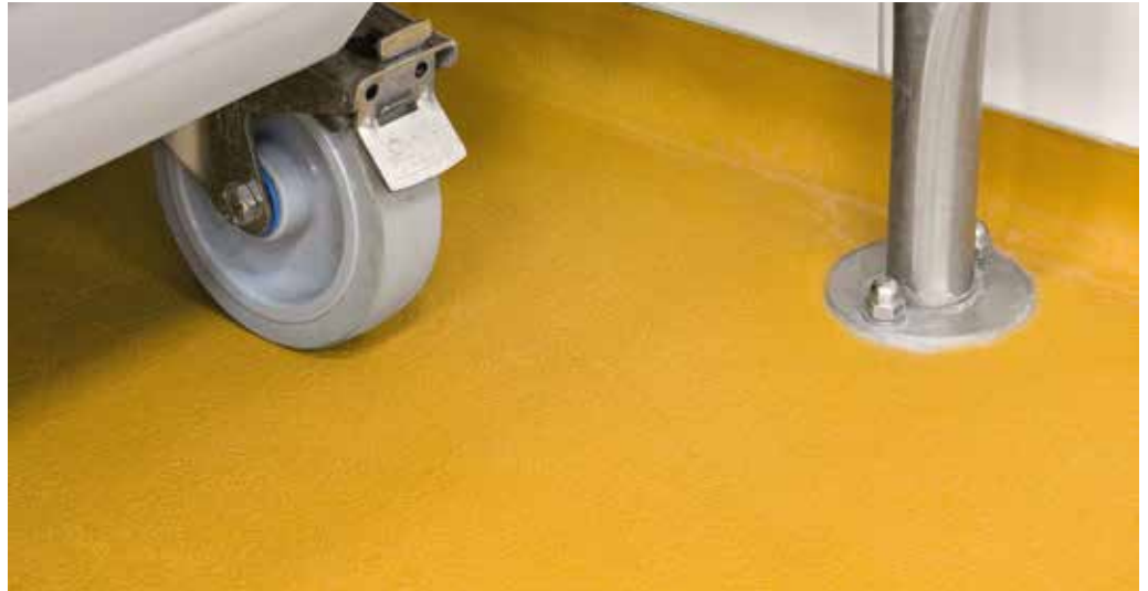
Unsere Referenz in Rüsselsheim (Deutschland): Großküche GPR Klinikum
