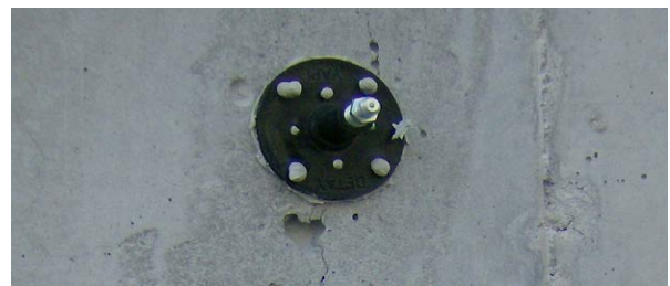
Platzierung des Klebepackers auf dem Riss
