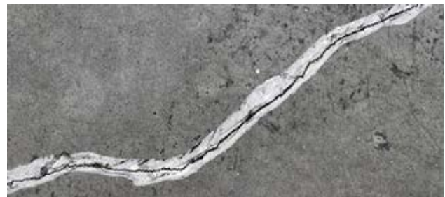
V-förmig geöffneter Riss in einem Betonboden
