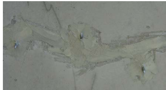
Bohrpacker korrekt verteilt auf beiden Seiten eines Risses und mit MasterFlow 920 AN oberflächendicht verspachtelt
