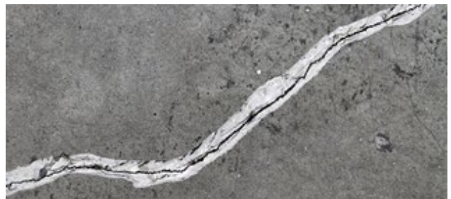
V-förmig geöffneter Riss in einem Betonboden
