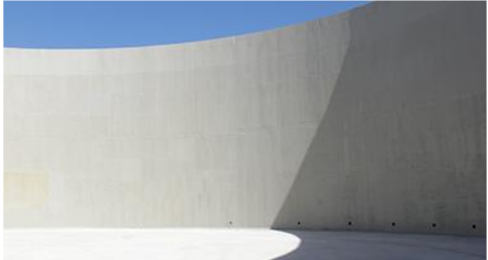
Estado del digestor una vez tratado con la membrana de protección e impermeabilización MasterSeal M 336.
