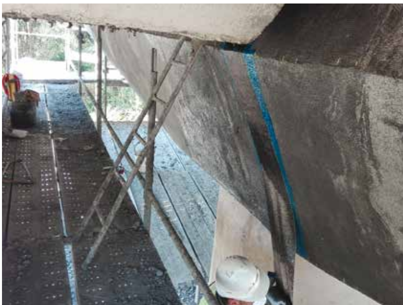
7. La fase di applicazione del tessuto MasterBrace FIB CFH sul pulvino del viadotto Santa Cecilia I
