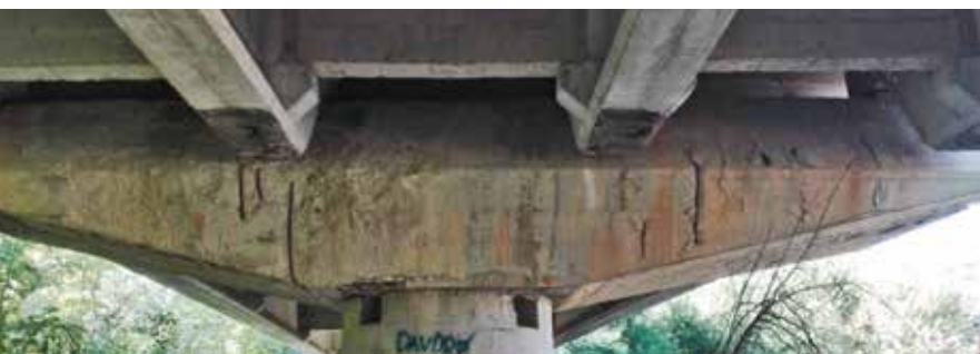
1. Lo stato di degrado dei pulvini del viadotto Santa Cecilia I
