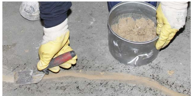
Figura 5. Nivelarea suprafetei fisurii cu ajutorul unui mortar epoxidic din gama MasterEmaco / MasterBrace
