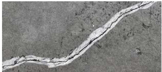
Figura 2. V deschiderea cu flexul in forma de V a fisuri
