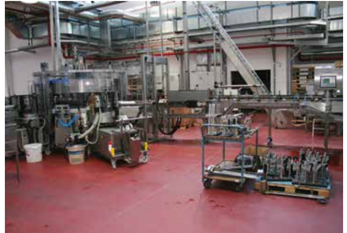
Unsere Referenz in Kitzingen (Deutschland): Abfüllanlage der Winzergemeinschaft Franken eG
