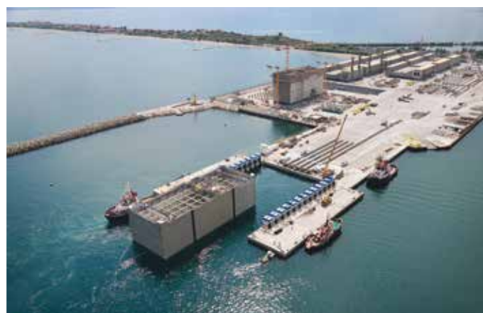
4A e 4B. Un esempio di realizzazione di un cassone in calcestruzzo
