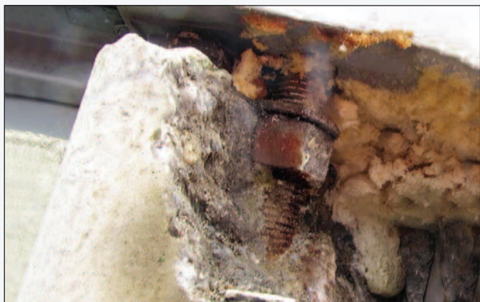
1. Un inghisaggio di tirafondi con problemi di sfilamento e/o rottura del supporto
