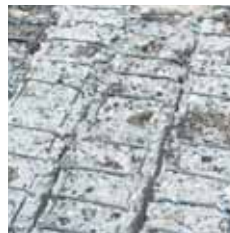
6.1.8 Negli interventi di rifacimento dei copriferro l'idroscarifica ad alta pressione consente una adeguata adesione di interfaccia
